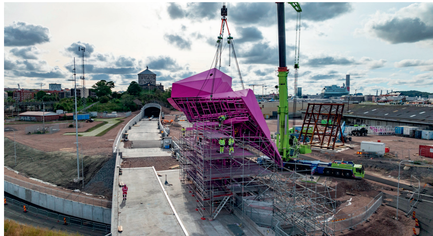
Här lyfts det komplexa konstverket bLink vid Västlänken i Göteborg på plats med hjälp av avancerad teknik.
