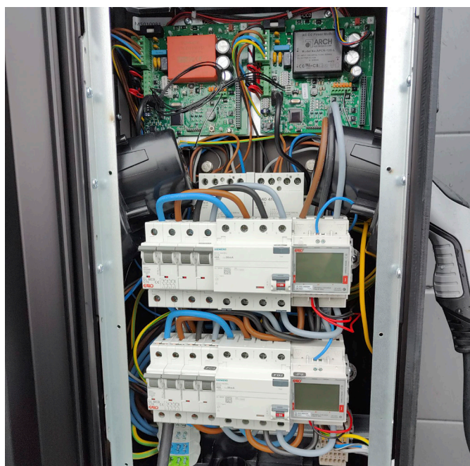
Installerad laddbox, signerat Elektrolund.
